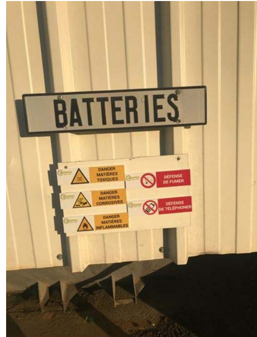
Photo 3. Affichage des consignes liées à l'entreposage des accumulateurs au plomb (Source : REMED)
